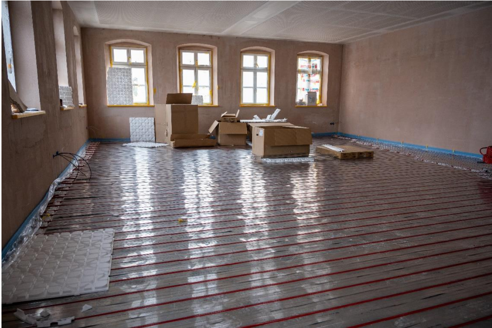
Im Obergeschoss entstehen Vereins- und Veranstaltungsräume, hier mit Fußbodenheizung
